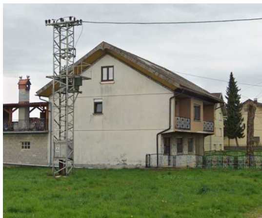
Slika 10. Trafostanica Hudi Bitek u Brezovičkoj ulici
